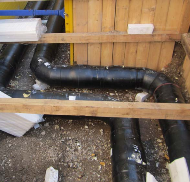
KMR-Trasse mit U-Dehner zur Vermeidung zu starker Spannungen auf der Leitung.
