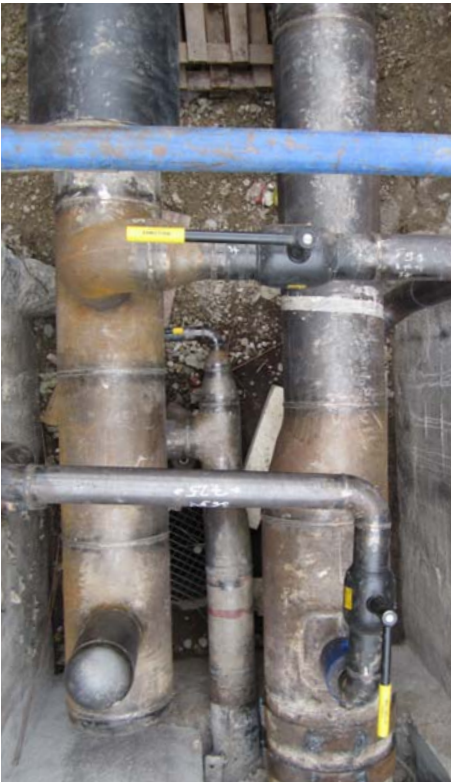
Draufsicht auf einen Umschlussschacht zur überregionalen Fernwärme- versorgung vor dem Aufsetzen der Schachtdecke.
