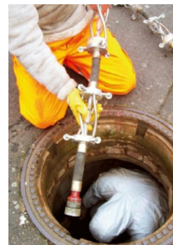
Mennicke bei der Durchführung der Kanalsanierung mithilfe der grabenlosen Inlinermethode am Opel-Werksgelände in Rüsselsheim.
