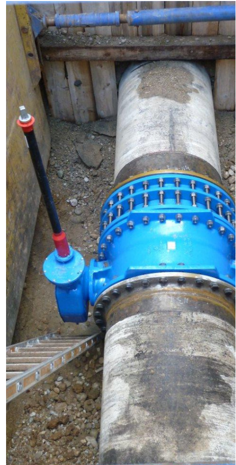
Trinkwasserleitung mit Vorschweißflanschen, Ausbaustück und Absperrklappe.
