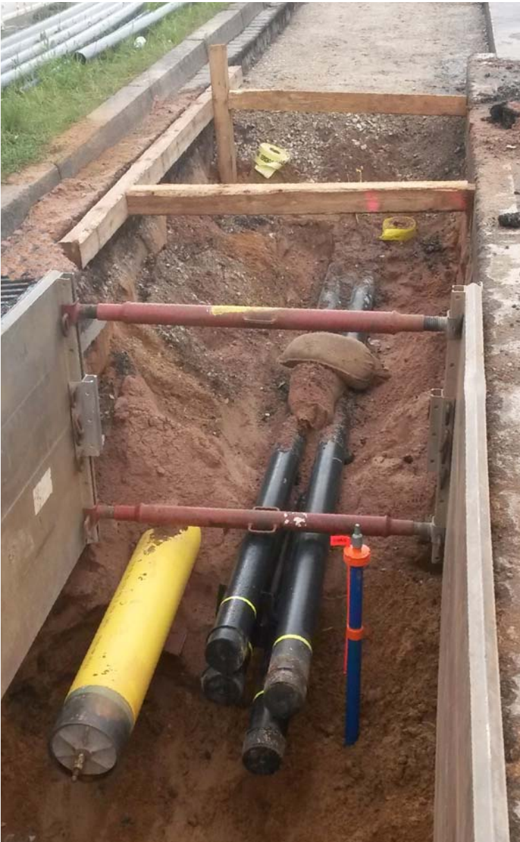
Werden mehrere Sparten nebeneinander in einer Trasse verbaut, ist die offene Bauweise die beste Wahl.
