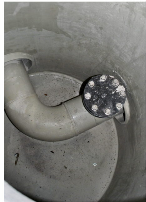
Ein Blick in einen der beiden Schächte. Durch das verwendete Rohr-in-Rohr-System ist die Gefahr von Undichtigkeit besonders gering.
