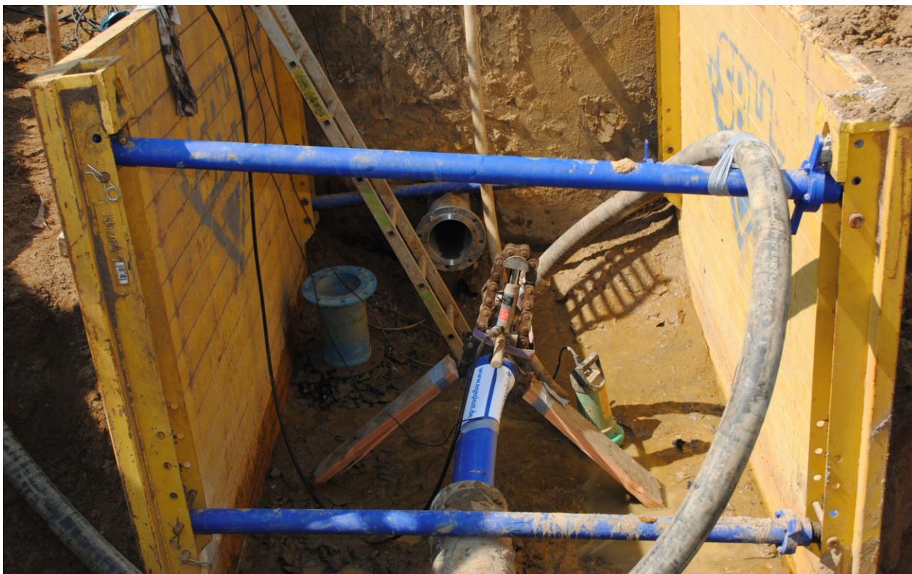
Der PE Liner wird mittels Seilwinde im zusammengefalteten Zustand in das Altrrohr eingezogen.
