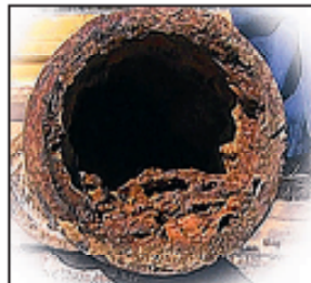
So sieht ein Wasserrohr nach 50 Jahren aus. FOTO: RBV
